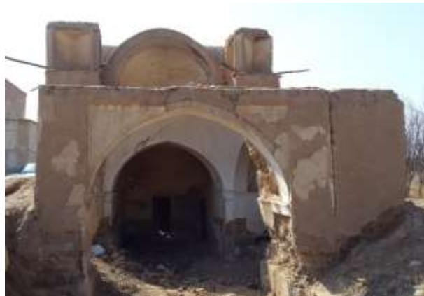
شکل ۴: حوضخانه میان باغ کاشانی و بادگیرهای آن که در حال حاضر تخریب شده است (رضا نبی، ۱۳۹۴)
