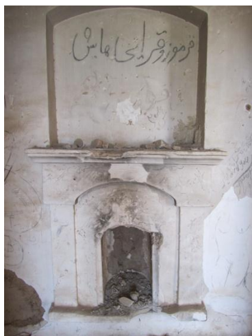
شکل ۹: پیش‌بخاری واقع در یکی از اتاق‌ها
